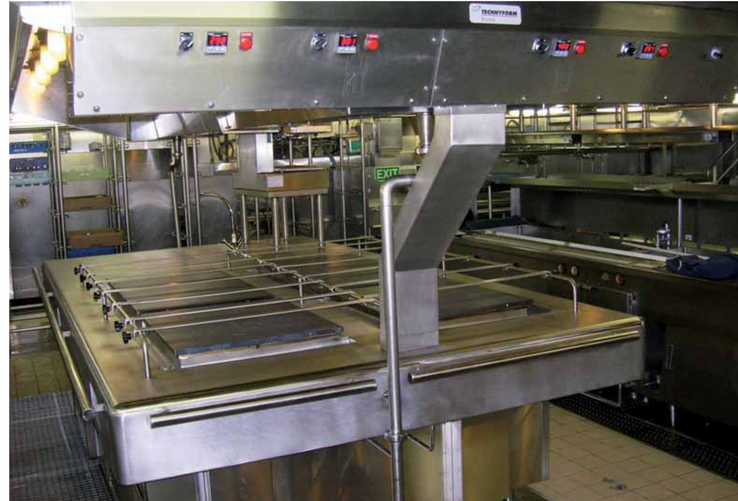
Fourneau central avec commandes déportées
